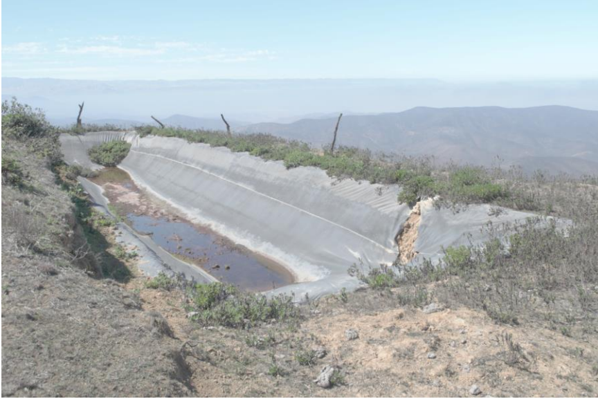
Figura 13. Reservorio ubicado al lado de canales que captan el agua desde atrapanieblas. ©2021 Carlos Amat y Leon
