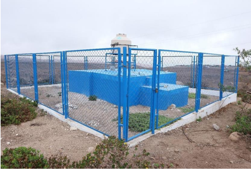
Figura 23. Fotografía del reservorio de agua de Santa Rosa. Se ha encontrado que las personas del anexo pagan alrededor de 25 soles de agua para consumo a través de cisternas. El agua que viene de las lomas la usan para quehaceres domésticos. © 2021 Diego Padilla
